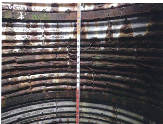
写真-3 内部腐食状況
