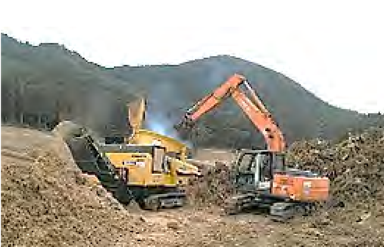
木材破砕機による破砕状況
